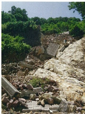
落石防護柵や擁壁が流出した土砂や流水により崩壊しました
