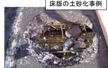
床版の土砂化事例
