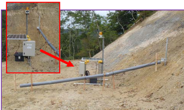
写真-14 伸縮計とサイレン装置
