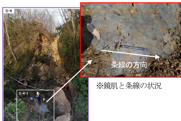
写真-2 頭部陥没帯の状況（図-3 ①）
