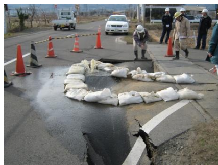
汚水の溢水状況
