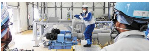
ALPS処理水移送ポンプの確認状況
